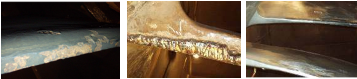
Fig. 3: Da esquerda para a direita: Pá de rotor da turbina hidroelétrica danificada pela erosão por cavitação. Recuperação da pá através da solda de reparo. Peça após o reparo. Foto: Tetyana Gurova
